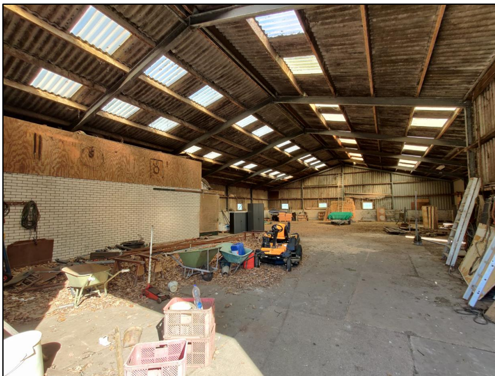
Figuur 4 Aan de binnenkant van de schuur is te zien dat er geen dakbeschot of spouwmuren aanwezig zijn.
