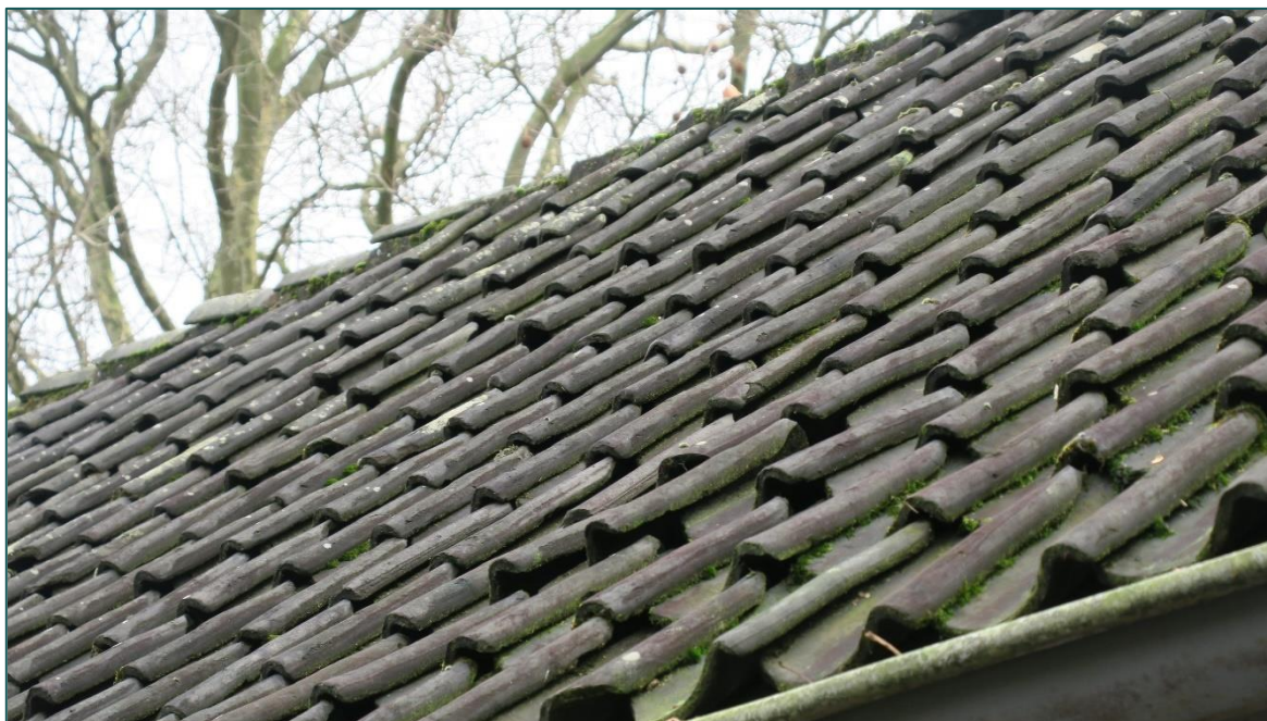
Figuur 3.1 Impressie van de scheefliggende dakpannen in de te slopen gebouw.
