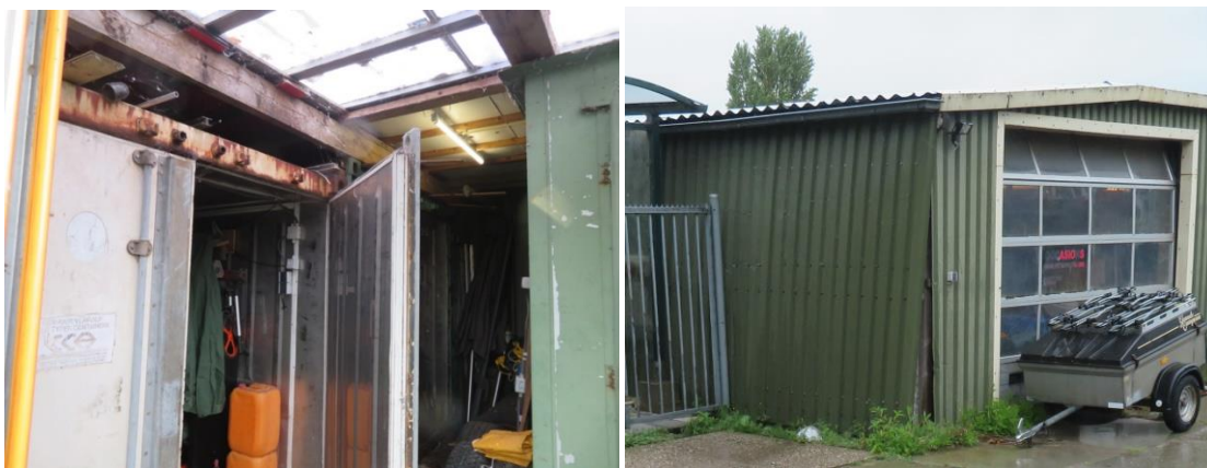
Afbeelding 5: Binnenkant loods met containers en niet geïsoleerd dak. Afbeelding 6: close-up buitenkant loods.
