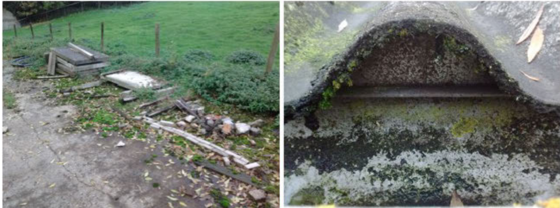
Figuur 3 Foto's rommelhoekje binnen het plangebied en dichtgewerkte dakpannen nabij dakgoot
