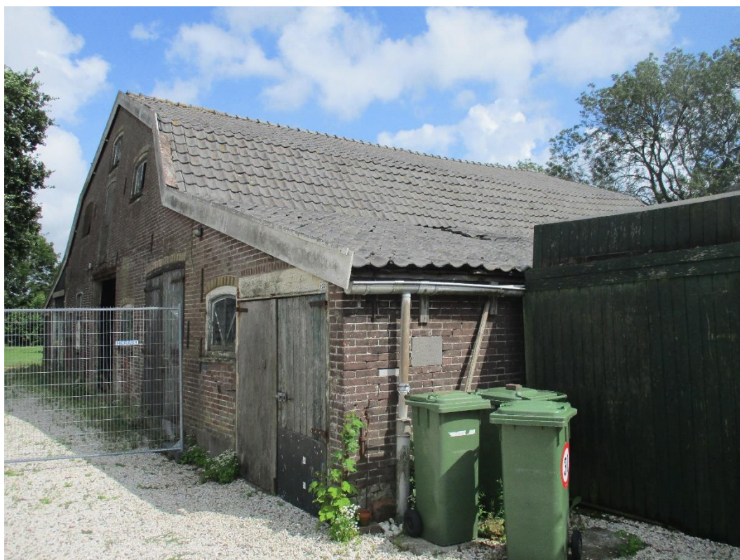
Figuur 2 De bestaande schuur (B) is in vervalen staat en beschikt over zadelpannen dak en gemetselde muren zonder spouw.
