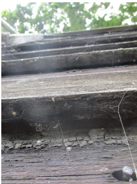
Figuur 2 De houten panelen zijn afgedicht en derhalve niet toegankelijk voor vleermuizen.
