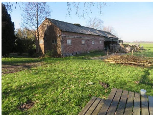
Afbeelding 3: Schuur met geërodeerd asbestdak (gedeeltelijk dakgoot).
