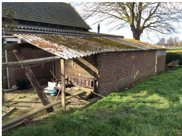
Afbeelding 2: Schuur achter woning met geërodeerd asbestdak zonder groot (2 stuks).
