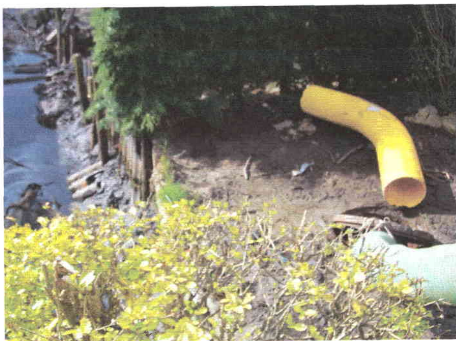
BOZ 3378 - pompinstallatie bij peilbuis
